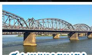
สะพานขาดตานตง
